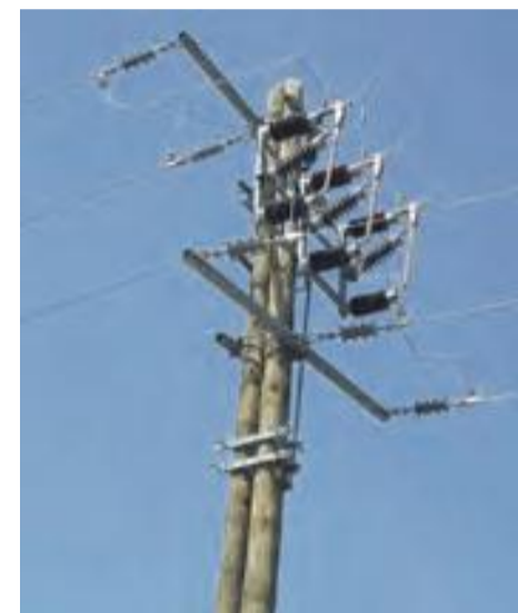
Apoio com interruptor aéreo de comando mecânico.
