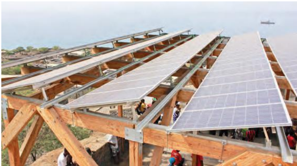
Módulos fotovoltaicos apoiados numa estrutura de madeira que contorna o pátio da escola primária
