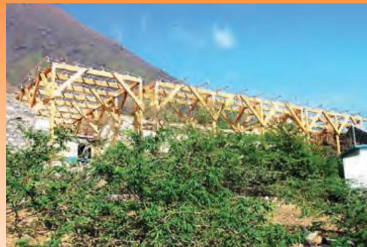
Estrutura suporte dos painéis fotovoltaicos (pátio da Escola Monte Trigo)
